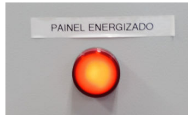
Sinalização Painel Energizado
