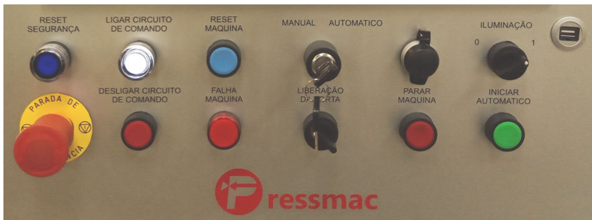
Sinalizações Botões Painel Operação
