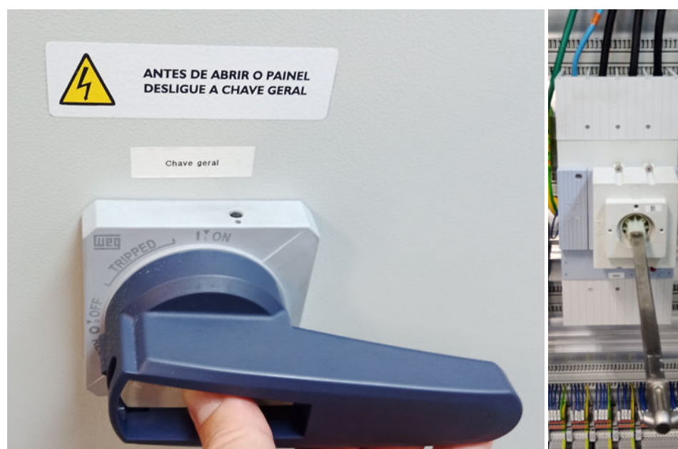
Seccionadora instalada na Máquina (foto externa)
