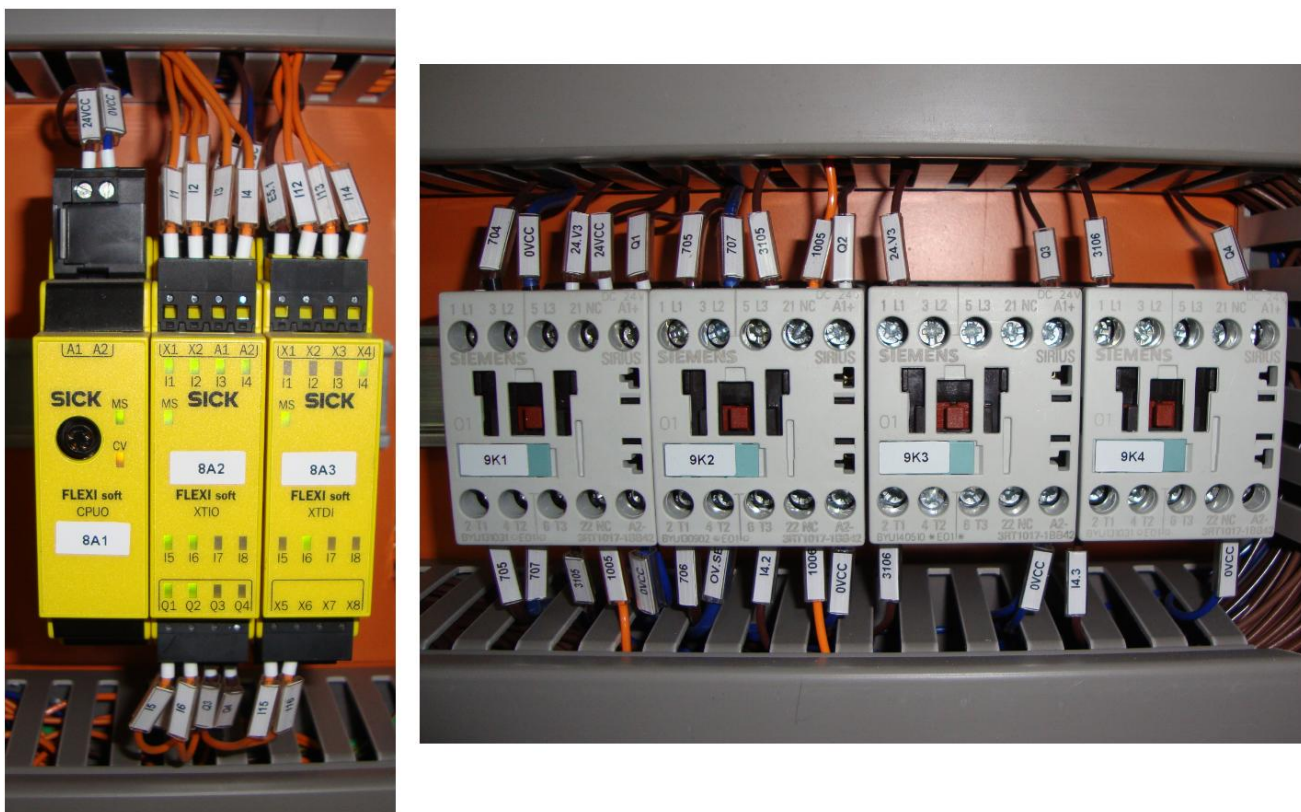
Figura 23 – Fotos Dispositivos de Segurança Painel de Comando
