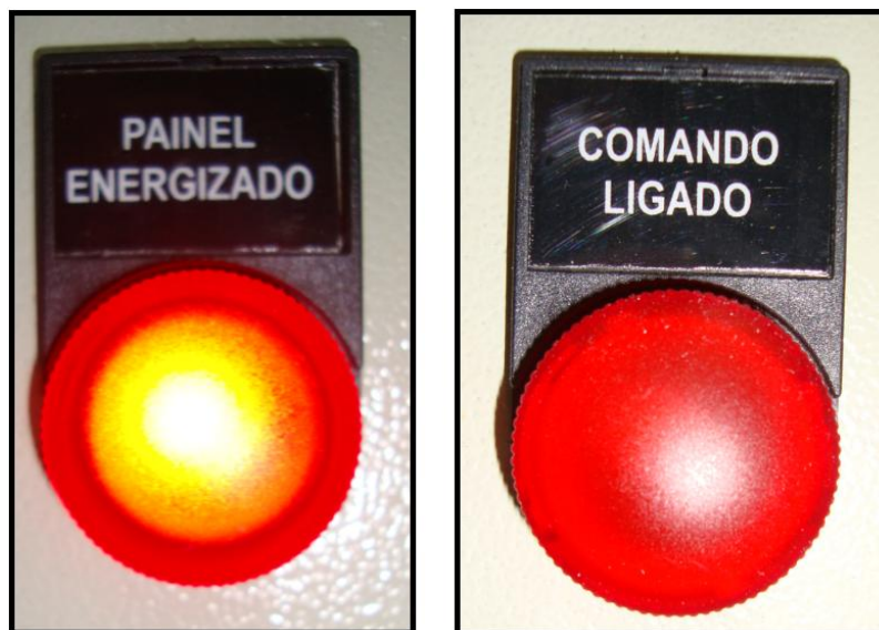
Figura 57 – Sinalização Alimentação Painel de Comando
