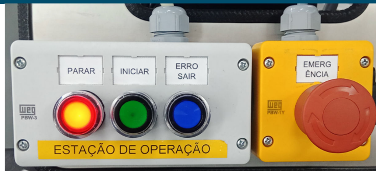
Botoeiras das Estação de Controle Principal 1 e 2
