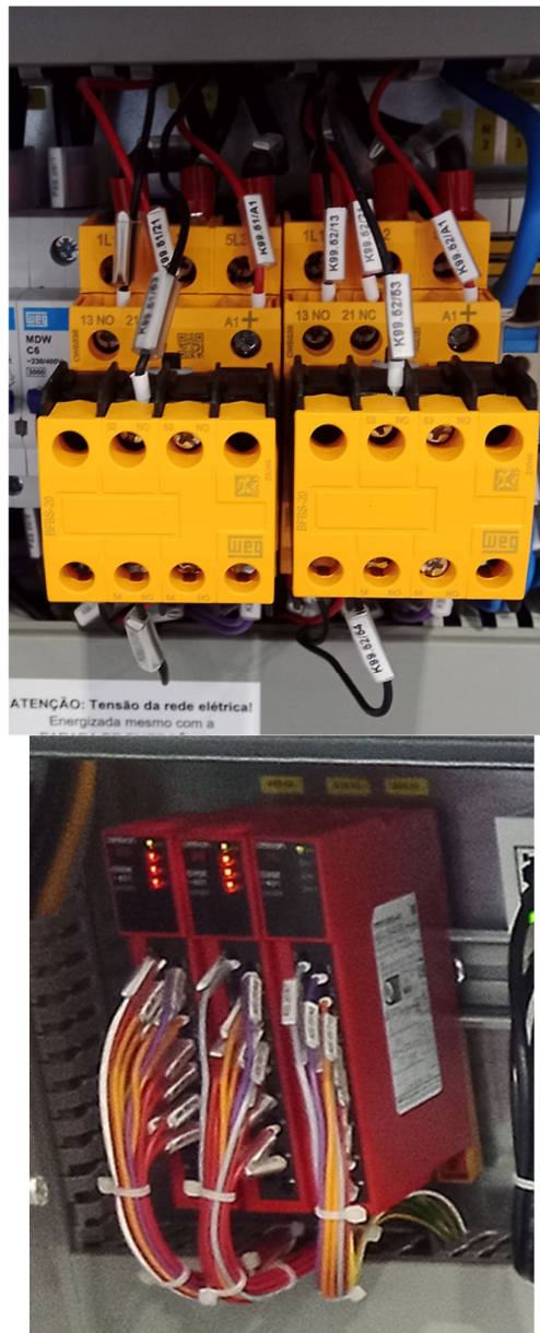
Fotos dispositivos de segurança Painel Elétrico
