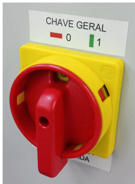
Seccionadora Instalada no Painel de Alimentação Principal da Linha (foto externa)
