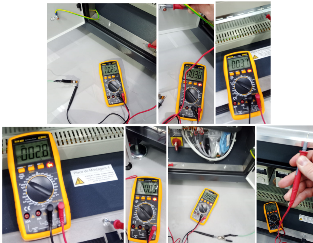
Medições dos Aterramentos máquina
