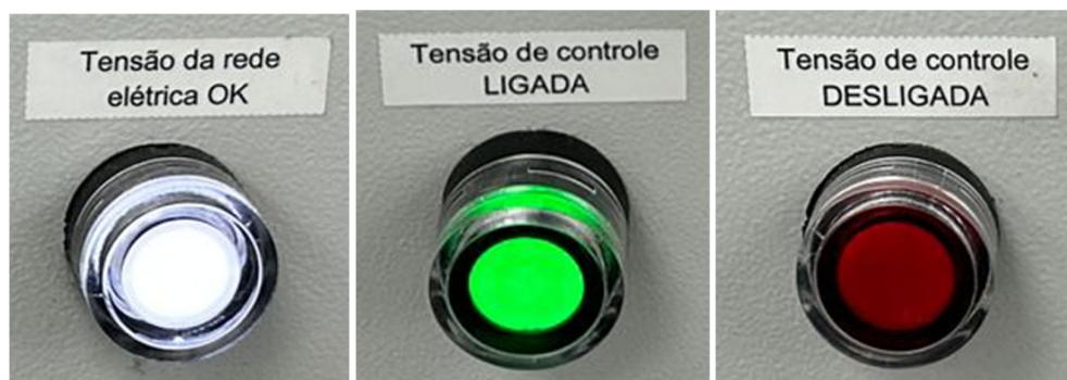
Sinalização Painel de Alimentação Principal
